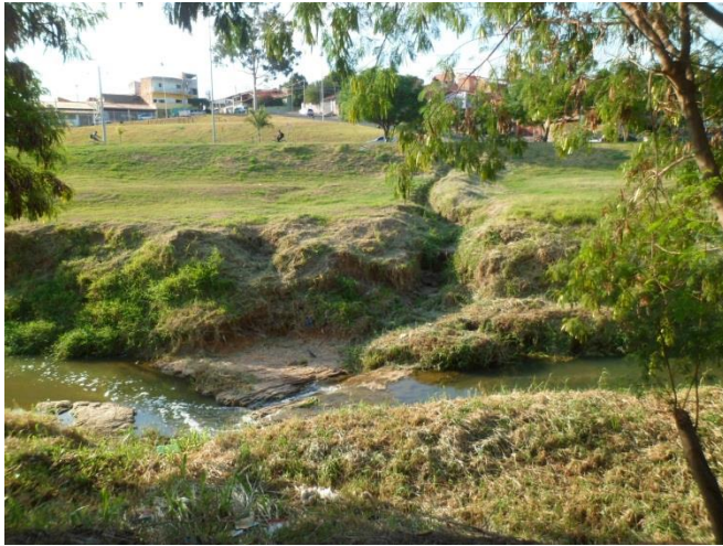
Figura 5.28 – Ponto de erosão no Córrego do Barnabé – Rua Custódio C. Carneiro e Rua Martinho Luthero
