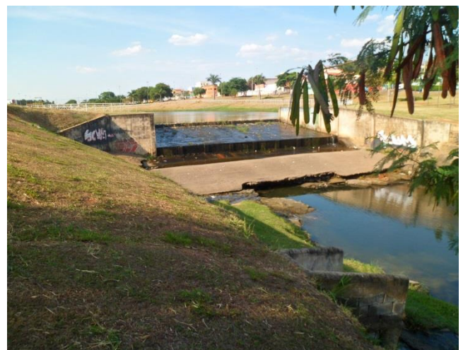
Figura 5.24 – Ponto de erosão no Córrego do Barnabé – Rua João Walsh Costa e Rua Antônio Angelino Rossi – Barramento SAAE
