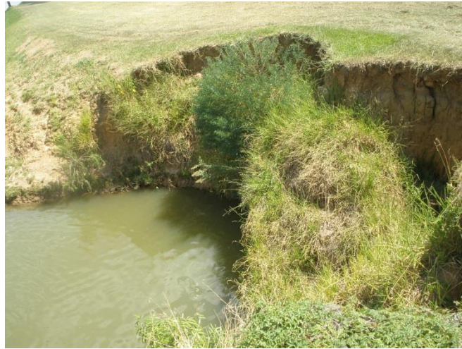
Figura 5.17 – T6 – Ponto de erosão a jusante
