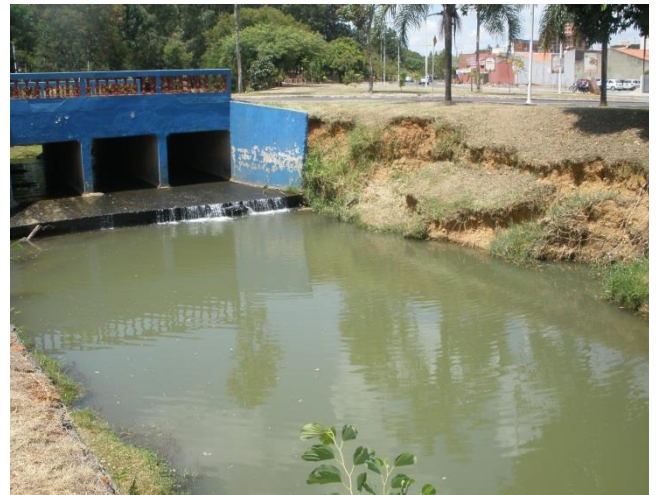
Figura 5.16 – T2 – Ponto de erosão a jusante
