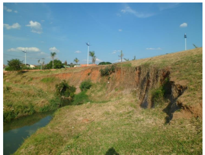
Figura 5.27 – Ponto de erosão no Córrego do Barnabé – Rua Custódio C. Carneiro e Rua Martinho Lutero
