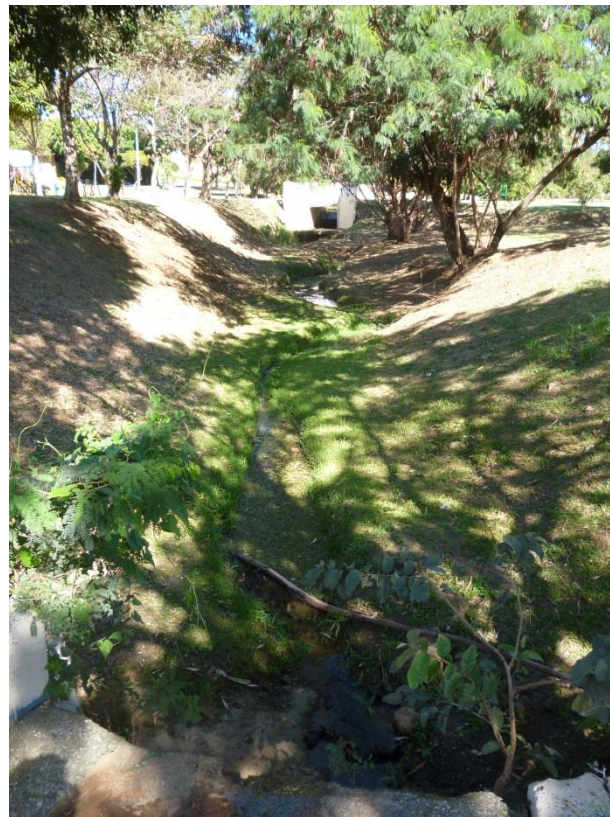
Figura 5.36 – Trecho Assoreado de Afluente do Córrego do Barnabé – Córrego São Lourenço
