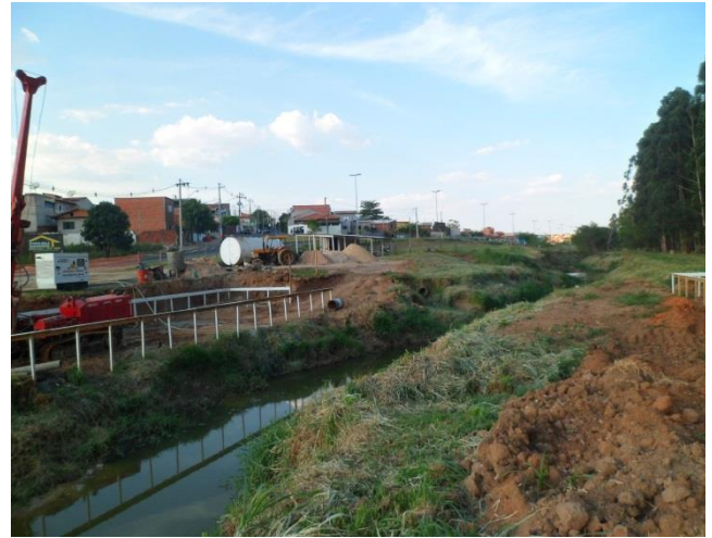
Figura 5.29 – Ponto de erosão no Córrego do Barnabé – Rua Custódio C. Carneiro e Rua Martinho Luthero
