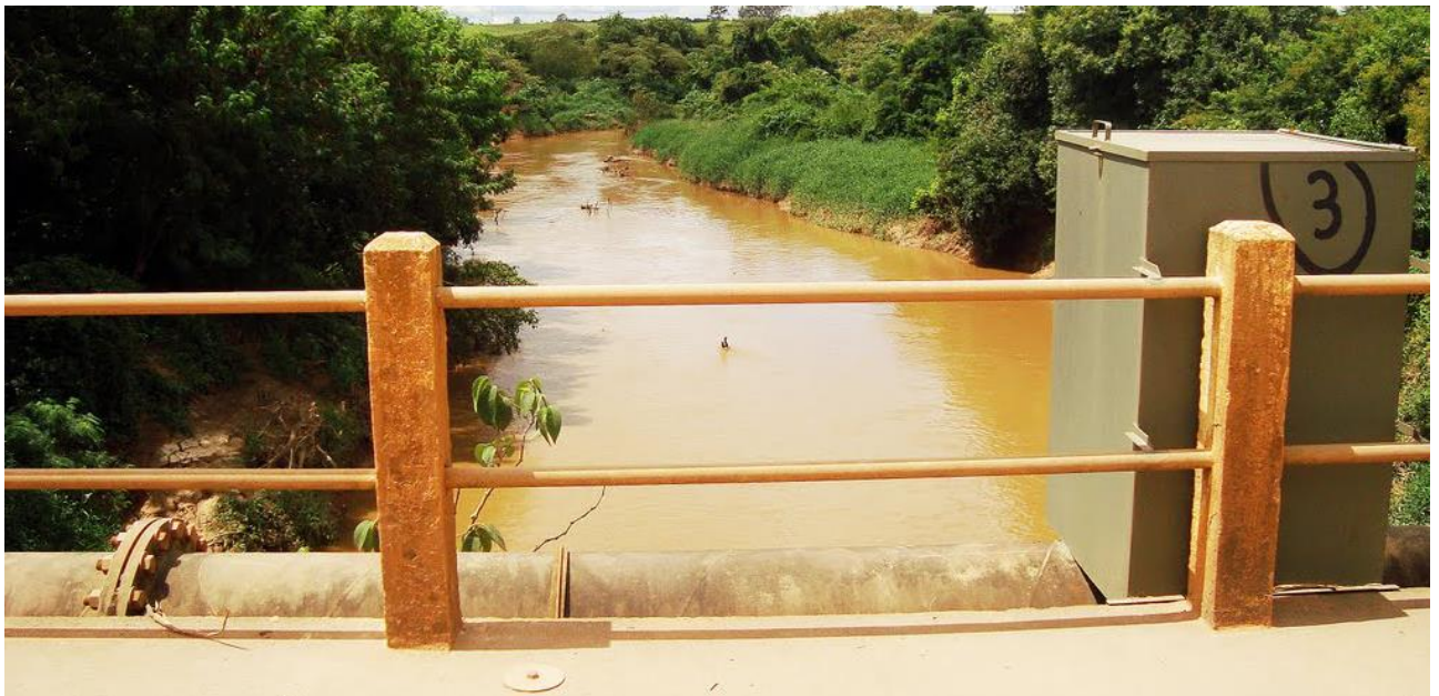
Figura 5.18 – Ponto de erosão próximo a ponte sobre o Rio Jundiáí, na Avenida Santoro Mirone
