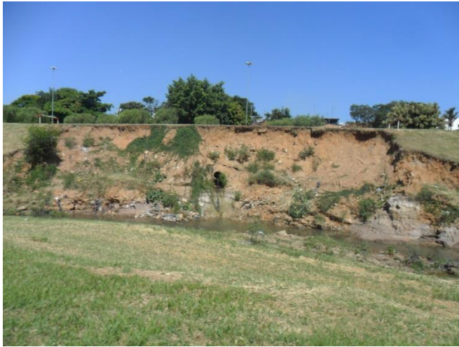
Figura 5.21 – Ponto de erosão no Córrego do Barnabé – Av. Manuel Ruz Perez e Av. Ário Barnabé
