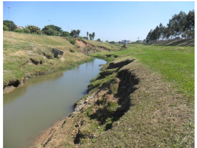
Figura 5.20 – Ponto de erosão no Córrego do Barnabé – Av. Manuel Ruz Perez e Av. Ário Barnabé
