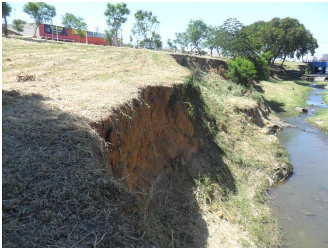
Figura 5.19 – Ponto de erosão no Córrego do Barnabé – Av. Manuel Ruz Perez e Av. Ário Barnabé
