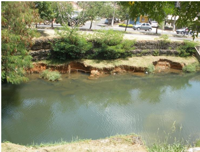
Figura 5.15 – T1 – Ponto de erosão a jusante, com vistas aos gabiões na parte superior
