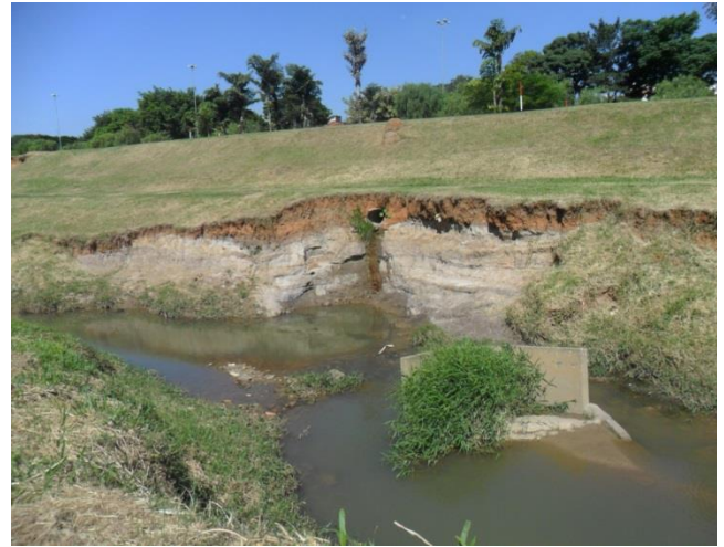
Figura 5.22 – Ponto de erosão no Córrego do Barnabé – Av. Manuel Ruz Perez e Av. Ário Barnabé – Queda do muro ala
