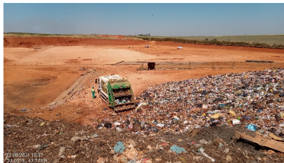
Figura 6.119. Vista durante descarregamentos resíduos no Aterro Sanitário
