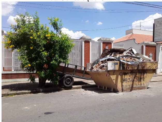
Figura 6.100. Vista de caçamba com Resíduos da Construção Civil
