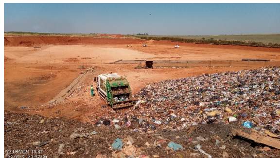
Figura 6.119. Vista durante descarregamentos resíduos no Aterro Sanitário
