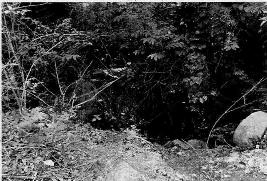
Imagem 4 - Rampa de escoamento danificada.
